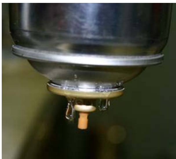
Fuite au niveau du dudgeonnage
